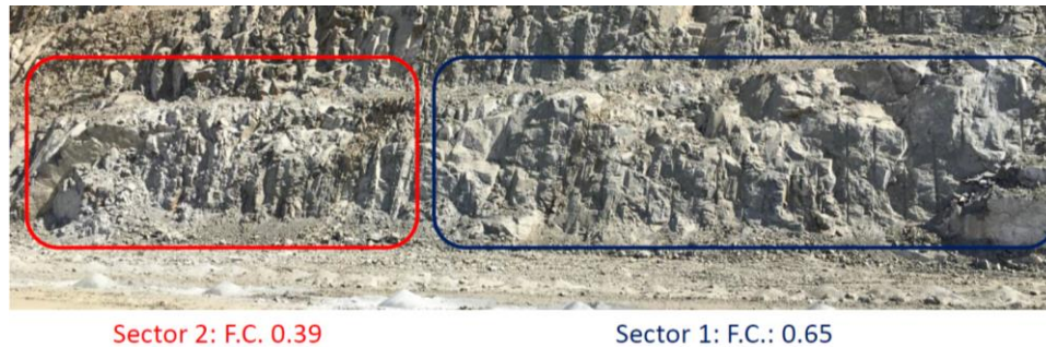
Figura 6.32- Fotografía que muestra sector tronado indicando los factores de condición por sector
