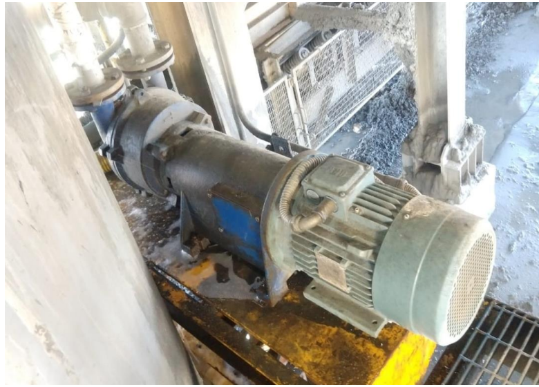
Figura N° 3.17: Bomba Auxiliar de vacío filtro 3. Fuente: Propia.
