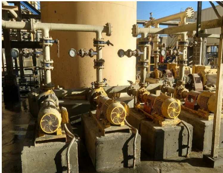
Figura N° 3.22: Estación de bombas. Fuente: Propia.
