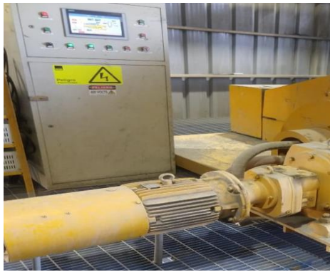
Figura N° 3.12: Motor eje filtro cerámico. Fuente: Propia.
