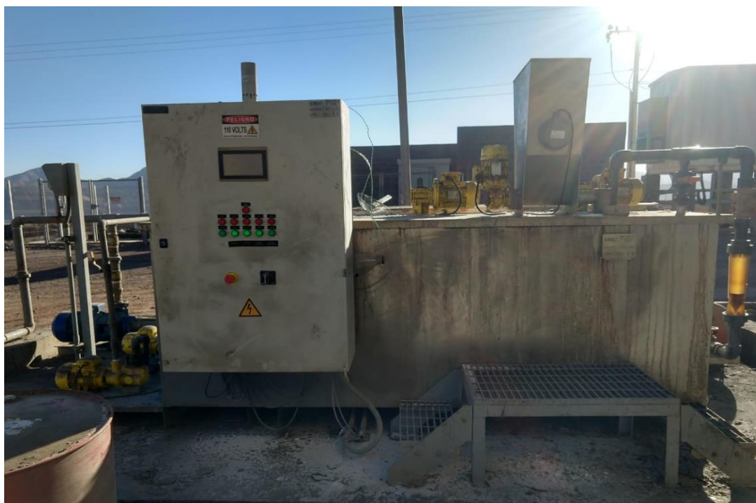
Figura N° 3.25: Planta de floculante. Fuente: Propia.
