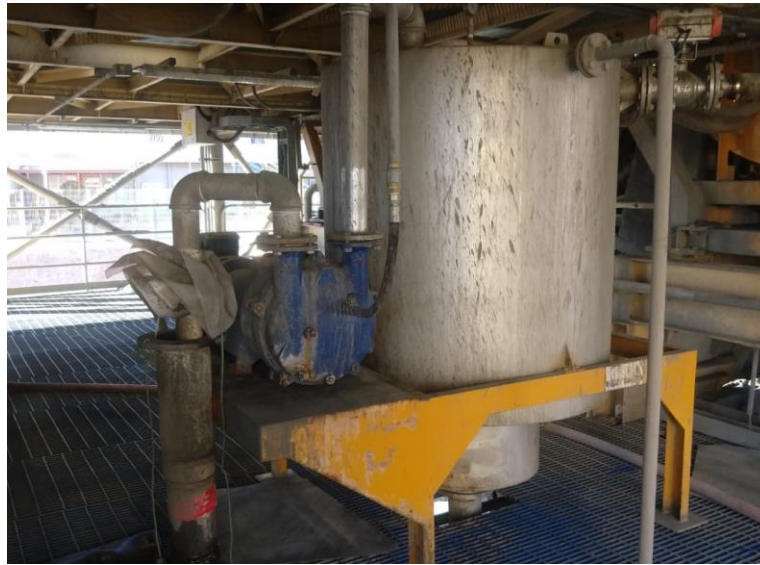
Figura N° 3.16: Bomba principal de vacío filtro 1. Fuente: Propia.
