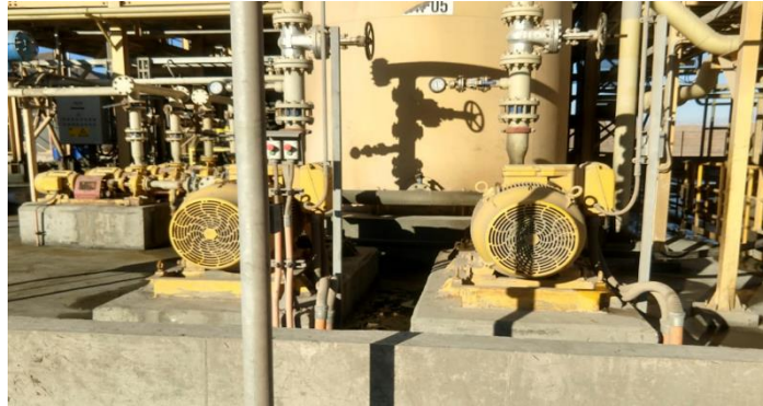
Figura N° 3.8: Estación de bombas. Fuente: Propia.
