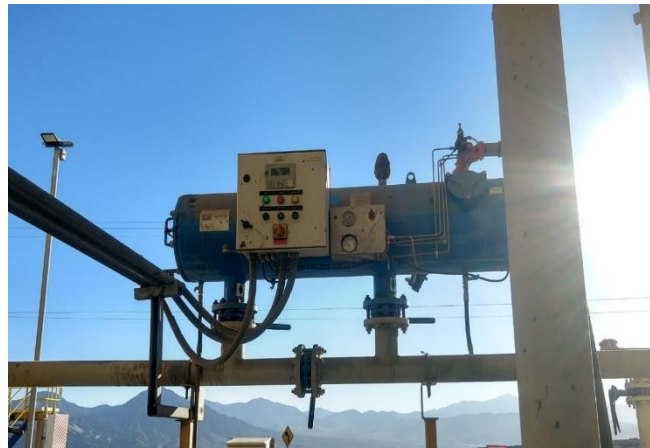
Figura N° 3.23: Filtro auto limpiante. Fuente: Propia.
