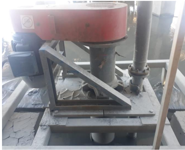
Figura N° 3.18: PP22 Bomba vertical sumidero. Fuente: Propia.
