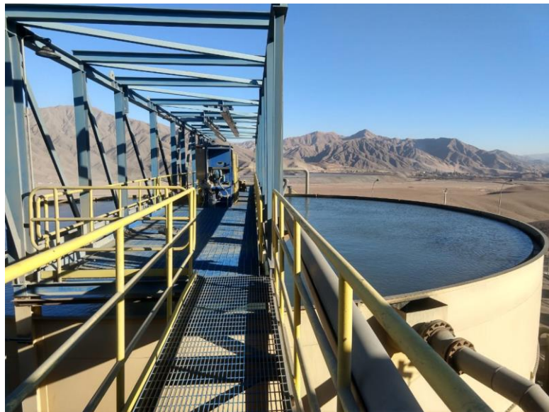
Figura N° 3.4: Espesador de relaves. Fuente: Propia.
